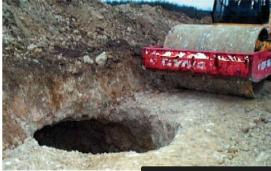
Figure 47 Découverte de façon fortuite d'une carrière souterraine à l'occasion de travaux de terrassement
